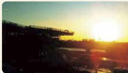
『日の出』 雲出島貞町 秀ちゃん 新香良洲橋の工事現場と日の出。4年3月頃完成か?
